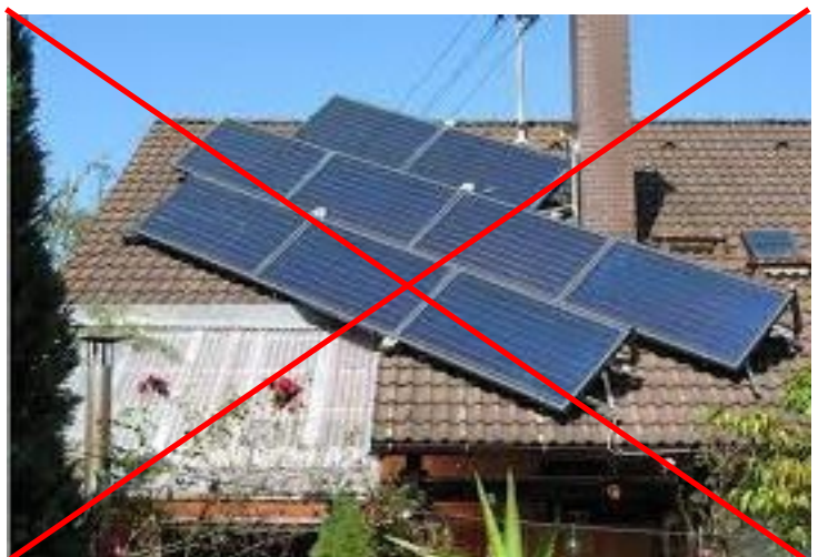
Anordnung der Panels ohne Rücksicht auf die Gebäude und Dachstruktur
